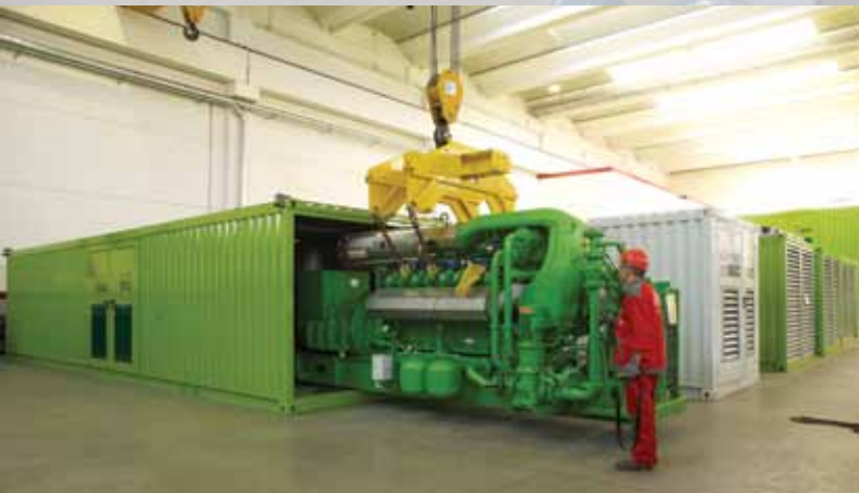
► incorporación del motor de cogeneración
